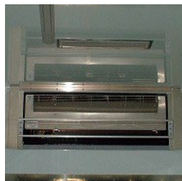
㉔ 冷凍機プロテクター
